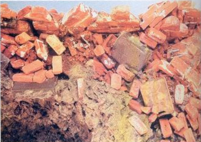
Детали разрушенной кирпичной стены. В кирпич удачно встроена кисть.
