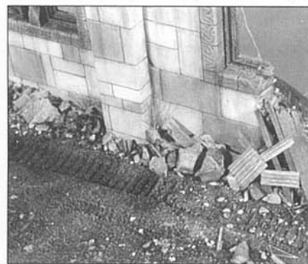
По периметру здания воспроизведен навал строительного мусора.
