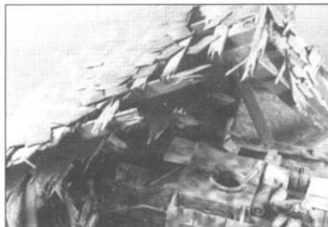
Разрушенная крыша фермы. Стропила и бимсы «искорежены» до сборки каркаса крыши.
