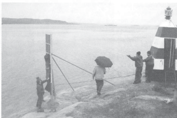
Солнечная энергетическая установка на мысе Шавор
