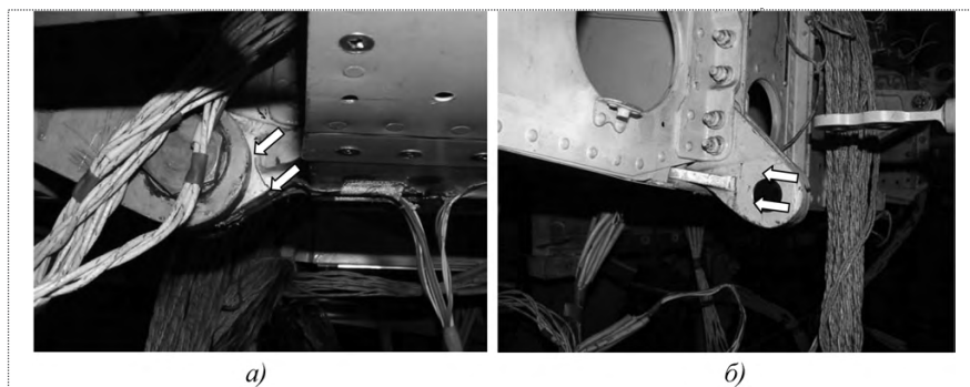
Рис. 6. Разрушения лонжеронных стыковочных фитингов: а — трещина 23 мм в нижнем фитинге первого лонжерона левой консоли крыла; б — трещина 19 мм в нижнем фитинге второго лонжерона левой консоли крыла
