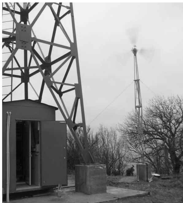
Рис. 3. ВЭУ-075 и контейнер для оборудования
