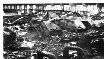
Рис. 2. Общий вид аварии ТА 300 МВт (2002 г.)
