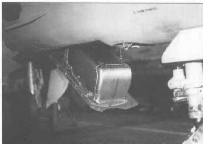
Сразу за стойкой основного шасси находился аккумуляторный отсек с двумя батареями 15-СКС-45. С помощью этих батарей питалась вся электрическая система самолета во время полета.
