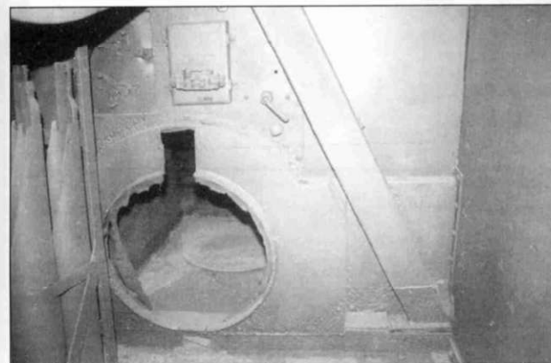
Противопожарная перегородка, вид со стороны отделения управления. Отверстие – под соединительный вал двигателя и трансмиссии, вал отсутствует, Синсхейм.
